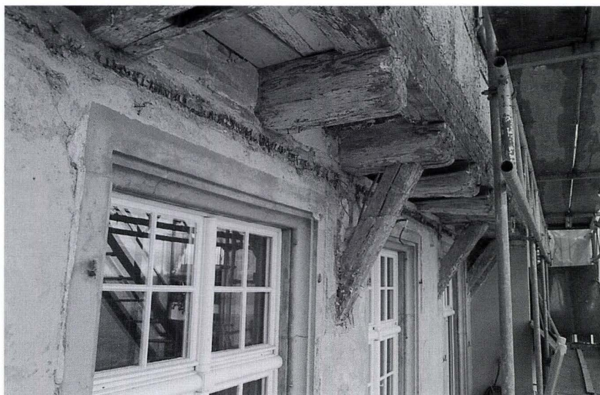
Abb. 1 Augustinergasse 11, Rheinfassade. Aus der Fassadenmauer auskragende Bodenbalken, die das darüberliegende Fachwerkgeschoss tragen. Im Mauerfeld zwischen den Bodenbalken hat sich die Malerei mit dem Diamantmotiv erhalten. – Foto: Basler Denkmalpflege (Blatt Nr. 1618, Bild 2; BC 13–14).
