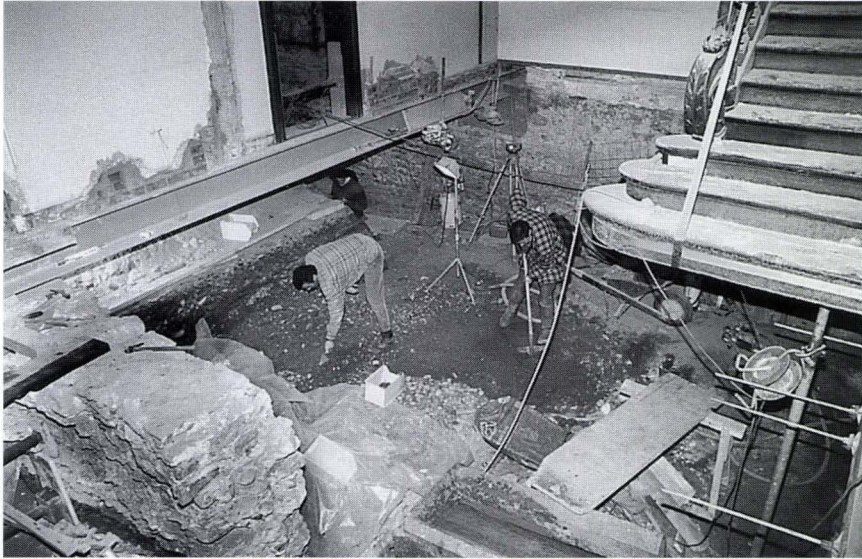
Abb. 46 Augustinergasse 19 (1998/28). Übersichtsaufnahme über die – parallel zu den laufenden Bauarbeiten – untersuchten Flächen im Inneren des Augustinerhofes. – Foto: Udo Schön.
