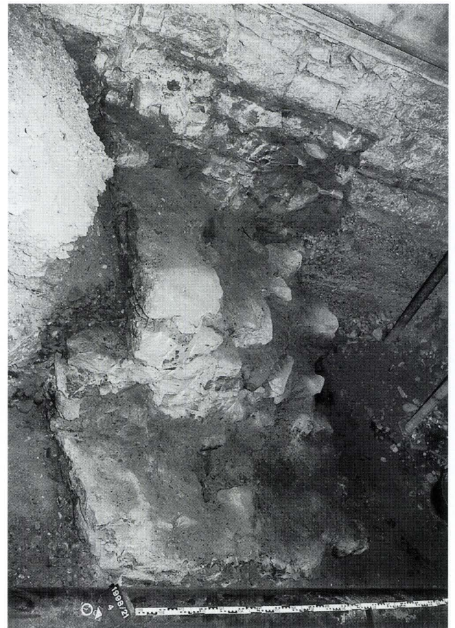
Abb. 44 St. Johanns-Platz 9 (1998/21). Blick auf die bei Bauarbeiten durchschlagenen Überreste der um 1843/1844 errichteten Eisenbahnstadtmauer. – Foto: Christian Stegmüller.
