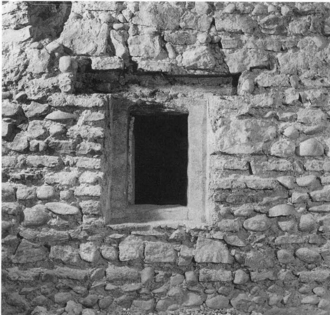
Abb. 3. Aeschenvorstadt 60/62, D 1986/12. Ostinnenwand im 1. Obergeschoss des Hinterhauses Aeschenvorstadt Nr. 60 mit Fenster in situ. – Foto: Basler Denkmalpflege.
