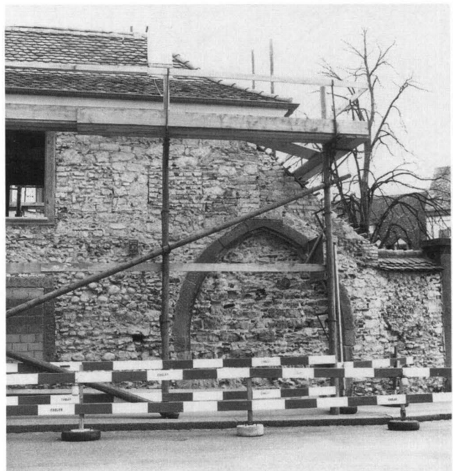
Abb. 4. Lindenberg 12, Hattstätterhof, 1988/40. Blick auf die Hofmauer bzw. die Längsfassade der «Mausefalle» mit dem zugemauerten Spitzbogenportal. Die Zinnen sind zwischen Fenster und Portal noch zu erkennen. – Foto: Basler Denkmalpflege.
