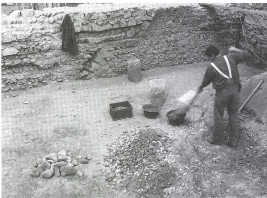
Abb. 90 Im Herbst 2001 wurde unter der ehemaligen Kasernen-Reithalle ein Stück der Kleinbasler Stadtmauer freigelegt. Dabei musste die ausgewitterte Aussenfront restauriert werden. Michael Kohler (Archäologische Bodenforschung Basel-Stadt) verwendete dazu an Ort und Stelle gewonnene Materialien: Grobkörniger Sand und Kiesel als Beischlag gaben dem Bindemittel (Kalkmörtel) die originale Farbe. Im Bild: die Rückseite der historisch ins Jahr 1278 datierten Mauer. Sie besteht weitgehend aus Kieselwacken, die beim Grabenaushub anfielen. – Foto: Priska Haldner.
