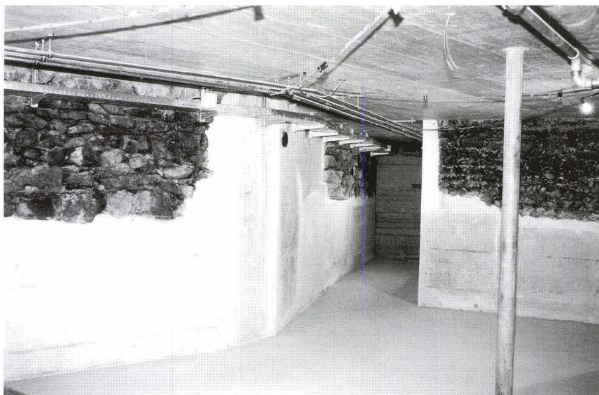
Abb. 38 Lohnhof: Der nordöstlich des Eckturms gelegene Keller nach erfolgtem Umbau. In der gebrochenen Betonmauer liegen links die Fundamente der Burkhardtschen Stadtmauer, von rechts stösst die jüngere Hofmauer des Chorherrengebäudes in Richtung Stadtmauer (Abb. 36, 6; Anschlussstelle wegen des modernen Durchgangs unterbrochen). Abb. 40 zeigt die Situation von aussen. – Foto: Udo Schön.
