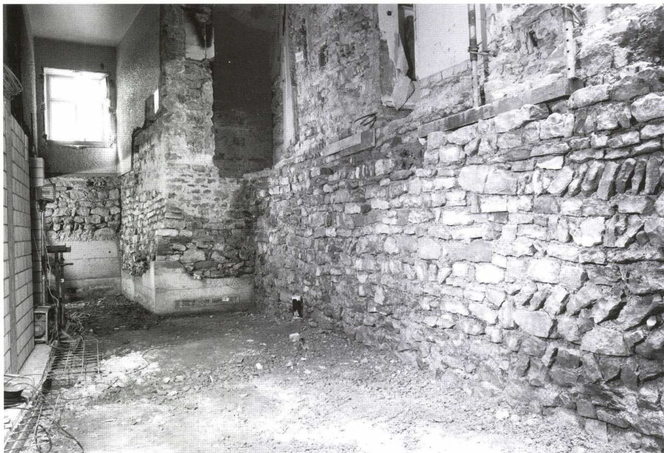
Abb. 42 Lohnhof: Blick in den frisch ausgehobenen Keller hinter dem Eckturm. Im Bild sind die teilweise modern unterfangenen Fundamente des Eckturms sichtbar (mit dem Loch der Eingangstüre im Erdgeschoss). Von rechts (von Norden her) schliesst die vom Leonhardsgraben herführende Burkhardtsche Stadtmauer an den Turm an, von hinten links (von Osten her) die weniger tiefen Fundamente dieser Stadtmauer. – Foto: Christian Bing.
