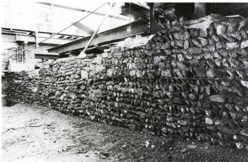
Abb. 26 Neuer Teufelhof, Leonhardsgraben 49: Die Hinterseite des Fundamentes der Burkhardtschen Stadtmauer nach erfolgtem Aushub.
