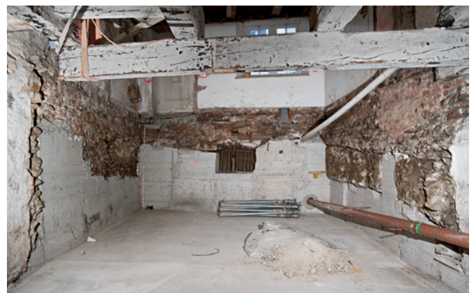
Abb. 26 Der Keller im Rohbau. Die Fundamente sind deutlich zu sehen (vorne die Fassade mit der Haustüre). Foto: Christian Stegmüller.
