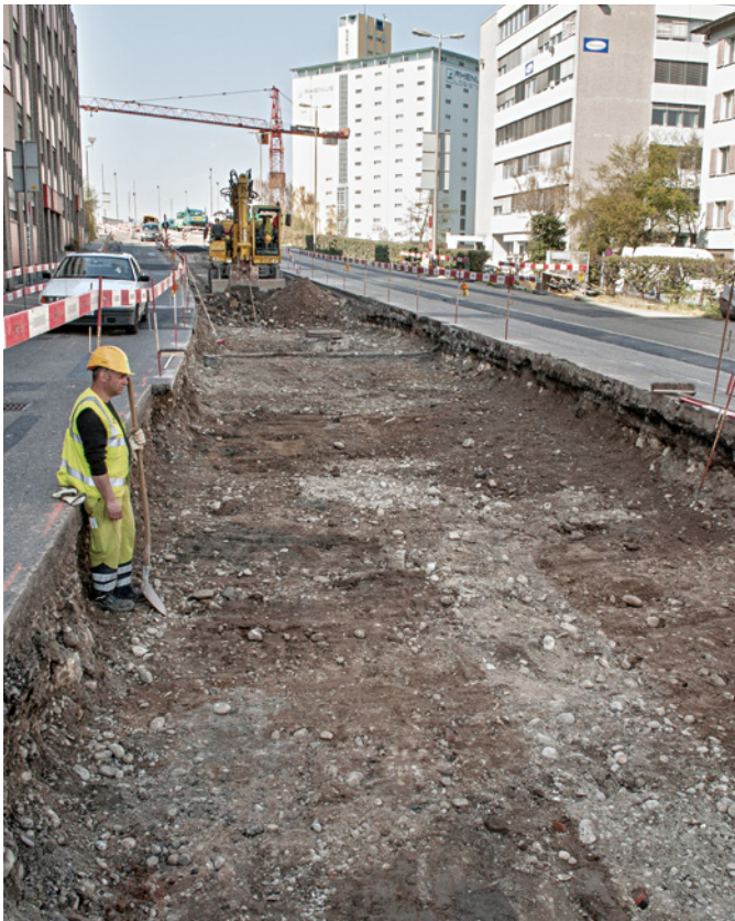
Abb. 50 Nach Aushub des Strassenkoffers zeichnet sich einzig das Fernheizungs-Trassee deutlich ab: Zu sehen ist das graue Band des eingefüllten Wandkieses. Foto: Christoph Matt.
