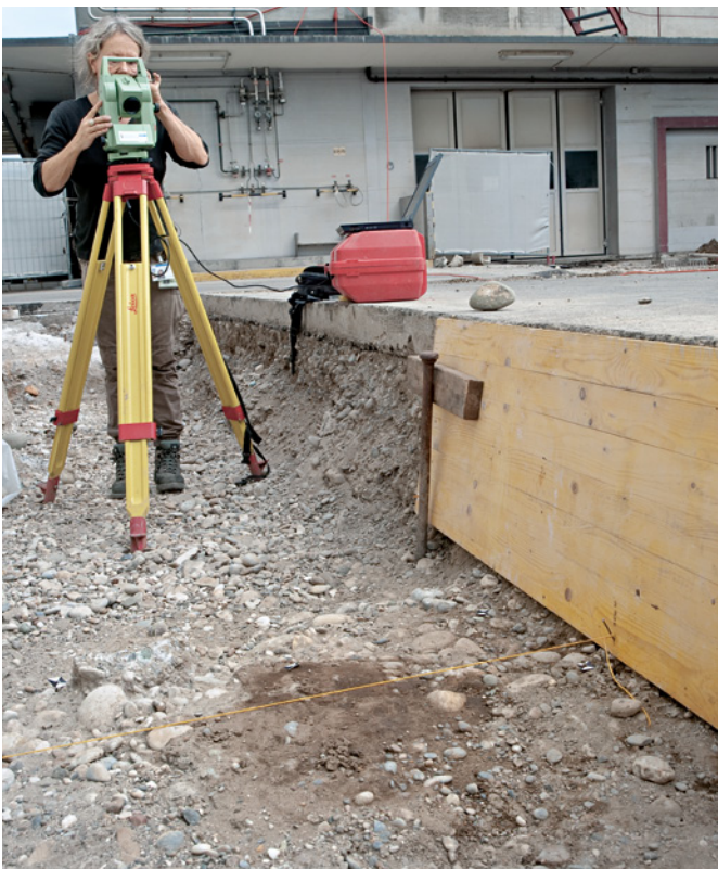
Abb. 47 Vermessungsarbeiten mittels Tachymeter für die Dokumentation einer kleinen Eintiefung, die sich im natürlichen Kies recht klar abzeichnet. Foto: Michael Wenk.
