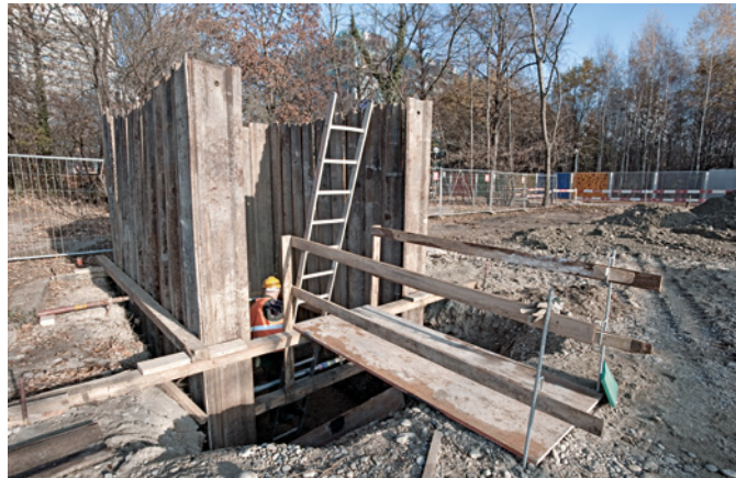
Abb. 36 An wenigen Stellen in der Voltamatte sind tiefere Bodeneingriffe nötig, die zu einer vorgängigen Untersuchung führen. Wenn möglich, werden Eingriffe in bereits untersuchtes Gebiet gelegt oder so verschoben, dass Befunde möglichst nicht zerstört werden. Foto: Michael Wenk.
