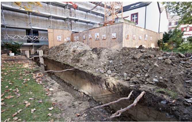
Abb. 27 Blick auf den Leitungsgraben im Hof des Altersheims mit dem Rohbau der Jazzschule im Hintergrund. Foto: Christian Stegmüller.
