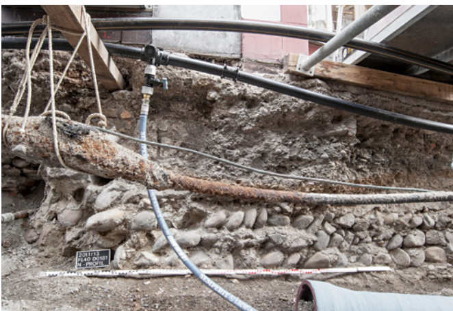
Abb. 15 Unter der etwas angerosteten Elektroleitung liegt leicht vorgelagert das über die Grenze zwischen den Häusern Spalenberg 44/46 hinwegziehende Fundament eines mutmasslichen Kernbaus. Foto: Christian Stegmüller.
