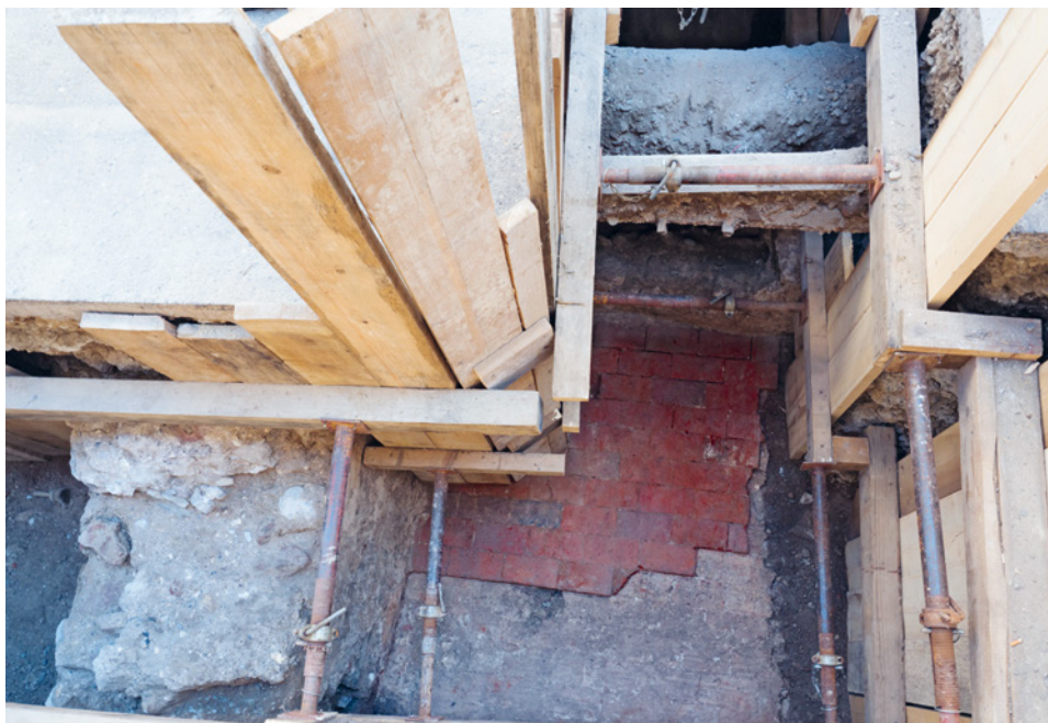
ABB. 24 Vor der Freien Strasse 4 wurde die alte Liegenschaft Nr. 1640 (Haus «zur Scher») aufgedeckt. Links erkennt man die massive, 1,3 m dicke Trennmauer zwischen Nr. 1640 und 1641. Die Fassadenmauer von Nr. 1640 liegt unterhalb der einbetonierten Leitungen. Sichtbar ist ebenfalls der letzte Kellerboden aus Baukeramikplatten in einem Mörtelbett. Foto: David Roth.
